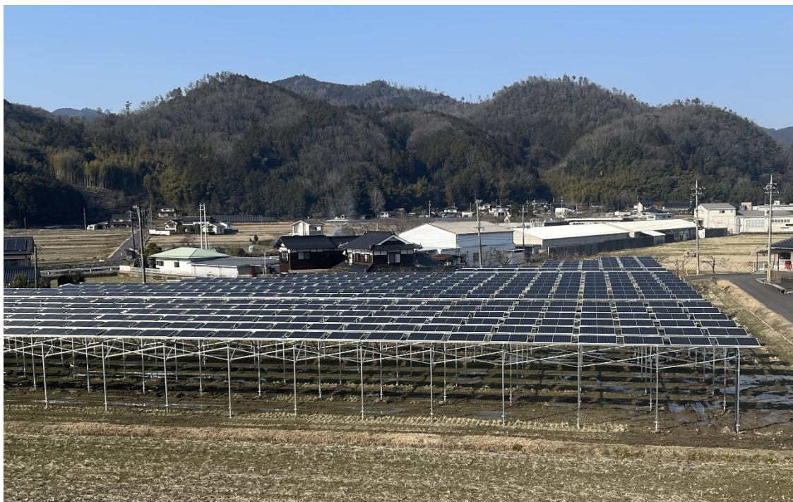
▲本社の隣に設置した営農型太陽光発電
